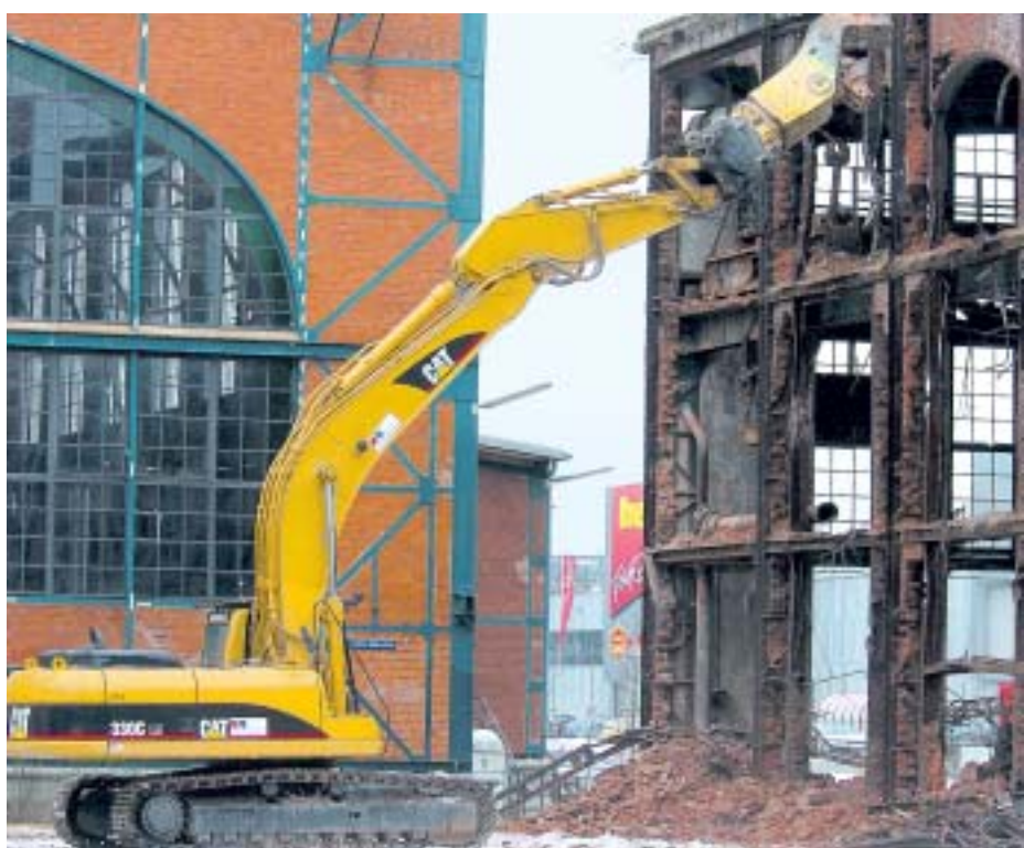
Gestern wurde mit dem Abriss eines alten Gebläsehauses auf dem ehemaligen Burbacher Hüttengelände begonnen.
